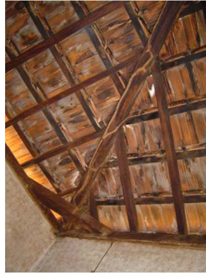
Figura 2 - Madeira degradada por cupim
