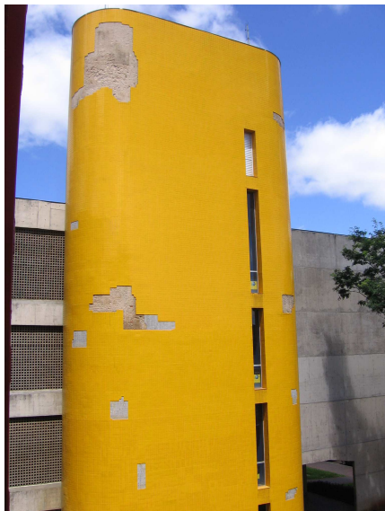
Descolamento do revestimento
